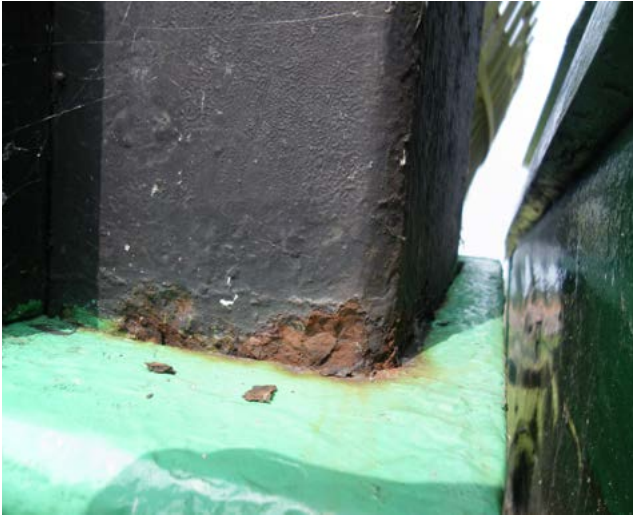
Putcorrosie bij askop
