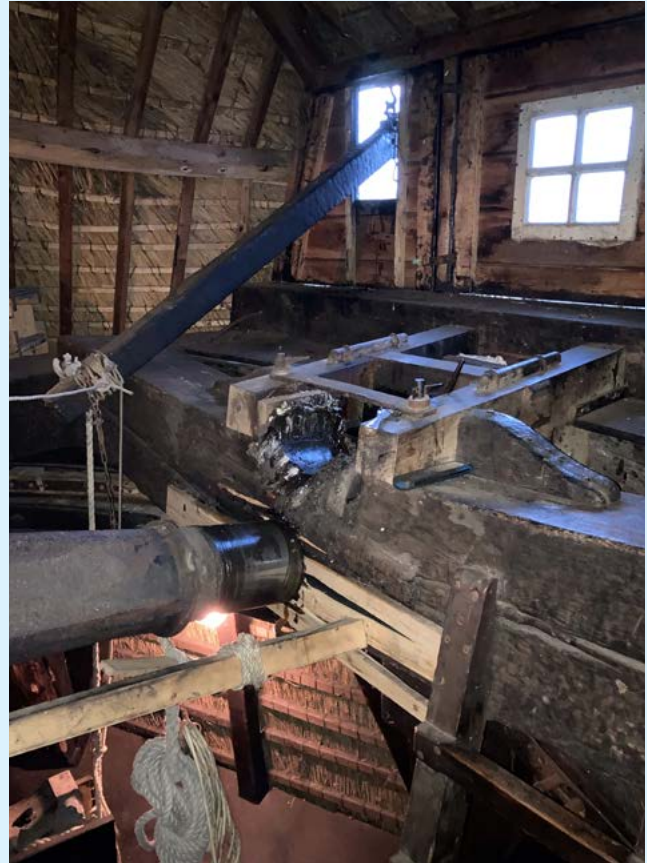
Schade aan binnenzijde kap na roedebreuk
