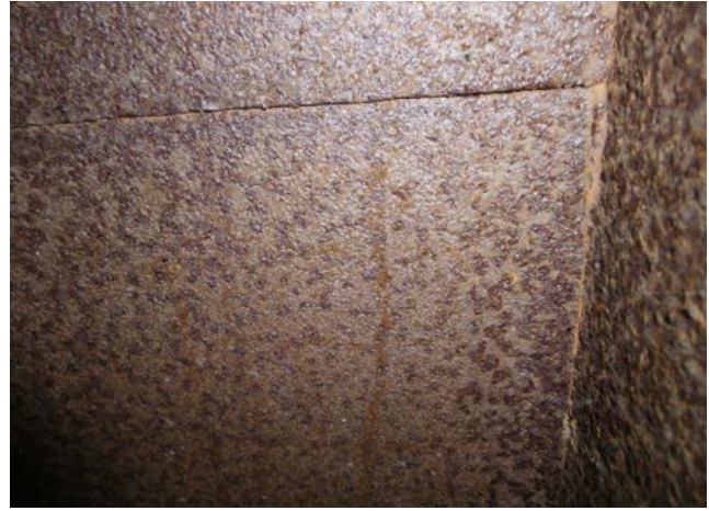
Onvolledige las (binnenzijde)
