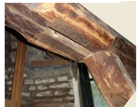
Schoor staander en arm vervangen door te kleine schoor
