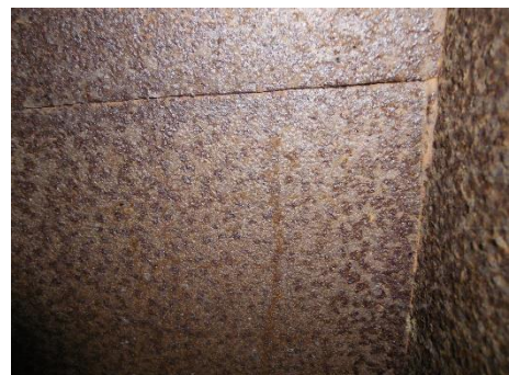
Foto bij 22 – In de stuiknaad is geen las zichtbaar. De roede is niet doorgelast.
